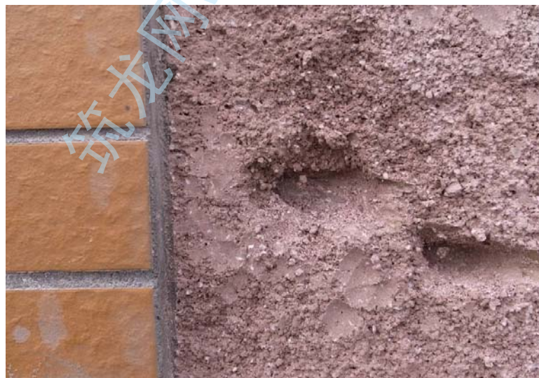
某项目保温砂浆未按照标准水灰比配制造成砂浆强度低，表面起壳
