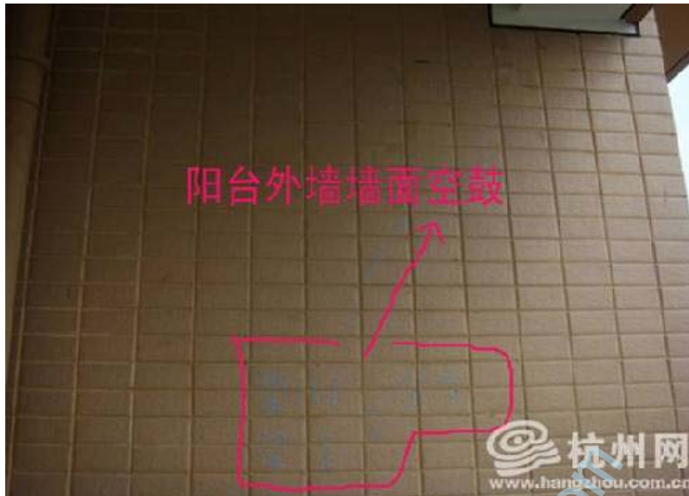
漏涂界面砂浆导致的空鼓现象，杭州丁桥经济房项目
